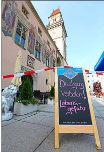
„Vorsorglich“ hat das Rathaus das Umfeld wegen möglicherweise lockerer Dachziegel gesperrt. – Fotos: Jäger
