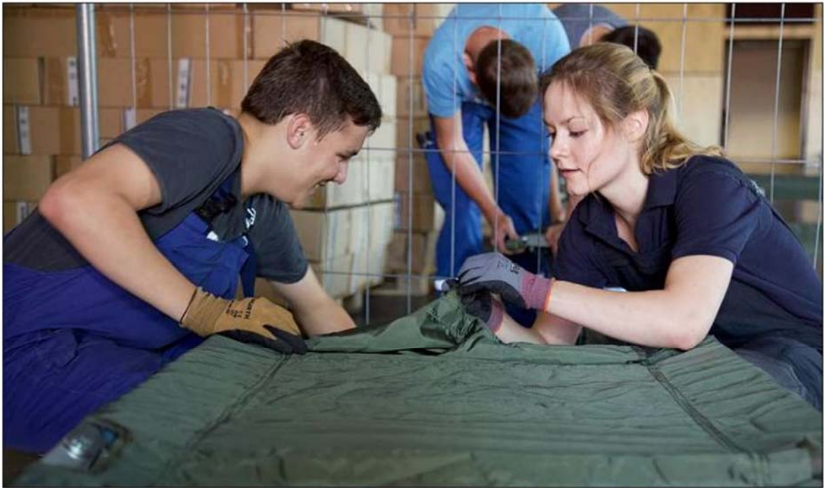
In nur fünf Stunden 150 Betten aufbauen – eine sportliche Aufgabe. Unterstützt wurden Stadt und Bauhof dabei von der Feuerwehr. Auch die Jugendtruppe hat mit angepackt. – Foto: fpassau.de/Kornexl
